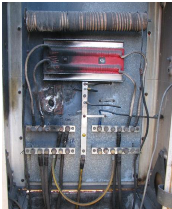
Slika 8: Poškodba elektro omare katodne zaščite zaradi prevelikih tokov
