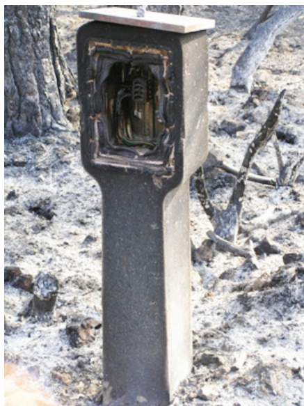
Slika 2: Poškodba stikalnega bloka zaradi požara
