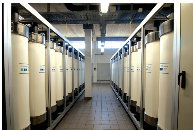
Pogled na nove ultrafiltracijske module
